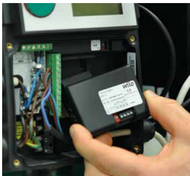
Tvillingpump Wilo-DP-E med påmonterade IF-moduler för central övervakning via överordnat automationssystem.
